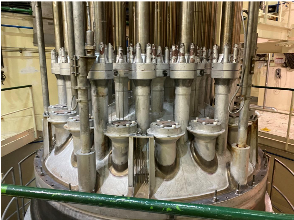
Obr. 8 Fotografie nátrubků HRK na víku reaktoru VVER 440.
