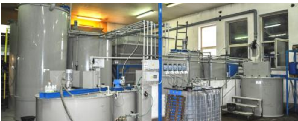
Obrázek 8: Ukázka neutralizační stanice [23].
