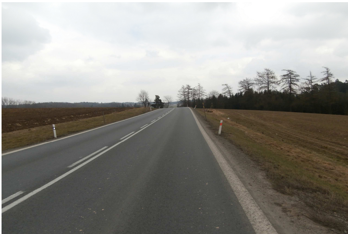
Příloha F - Špatně značený úsek silnice I. třídy č. 34
