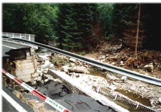
Obr. 9: Ničivé škody na pozemní komunikaci při povodni v roce 2002 ve Štěpánově nad Svratkou (Městys Štěpánov nad Svratkou ©2023)
