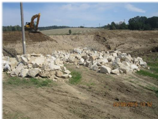
Obr. 30: Stavba hráze při realizaci PPO v obci Přiseka. Fotografie pořízena při průběhu stavby dne 23.8.2015 (OÚ Přiseka 2015)
