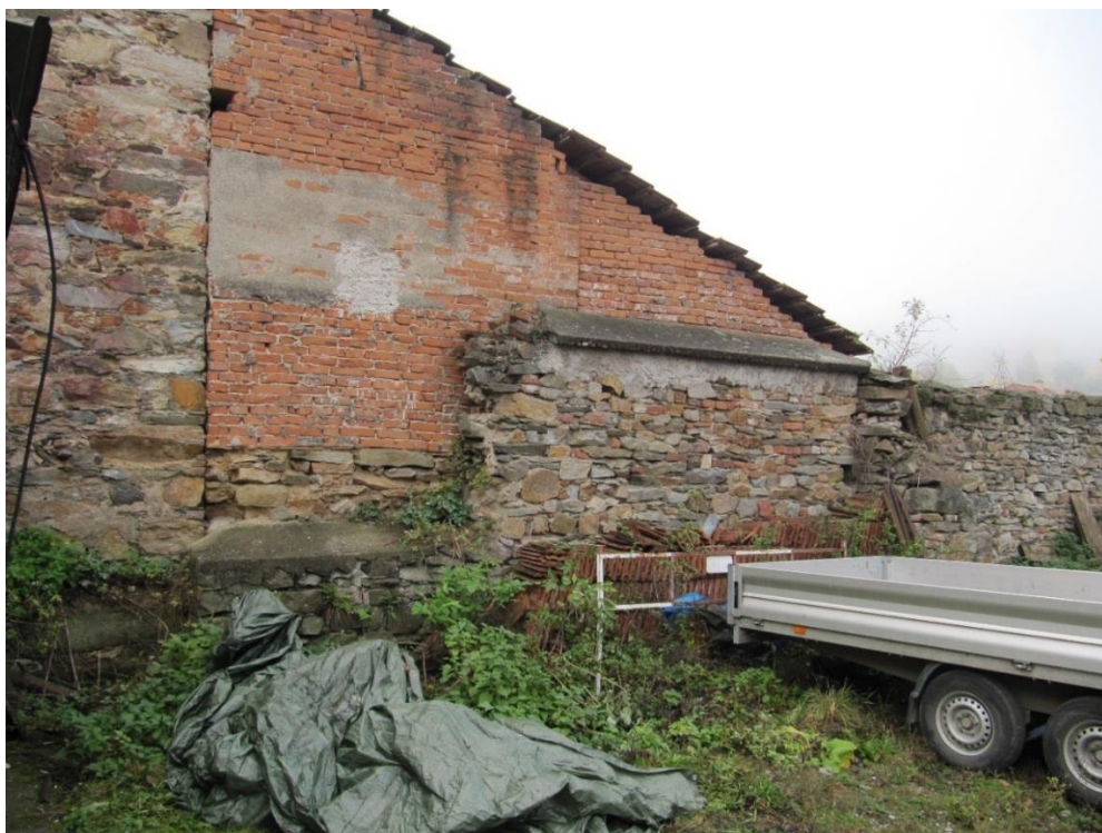
Obr. 30 – Ukázka přiléhajícího zbořeného zdiva; zdroj: vlastní foto autorky
