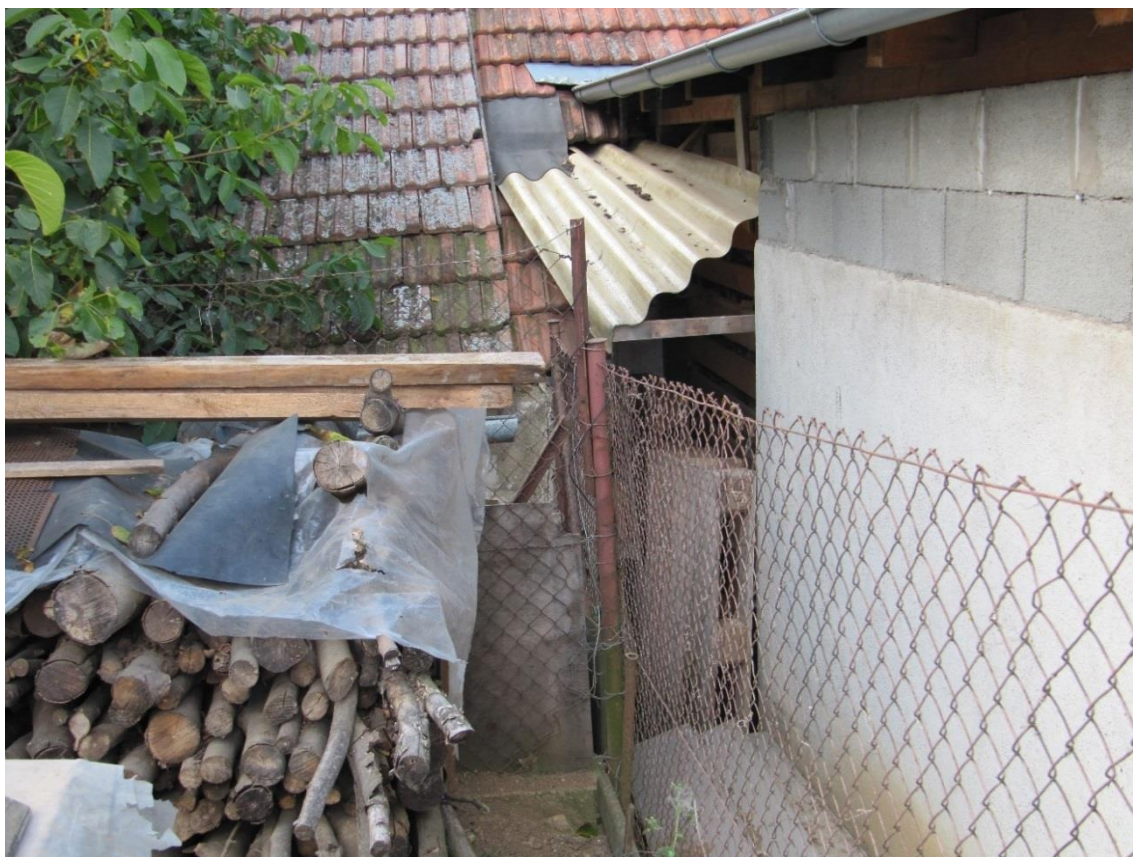
Obr. 33 – Nepřístupný roh budovy; zdroj: vlastní foto autorky
