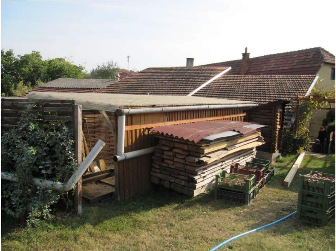
Obr. 34 – Zadní stěna hospodářské budovy zastavěna různými přístřešky; zdroj: vlastní foto autorky
