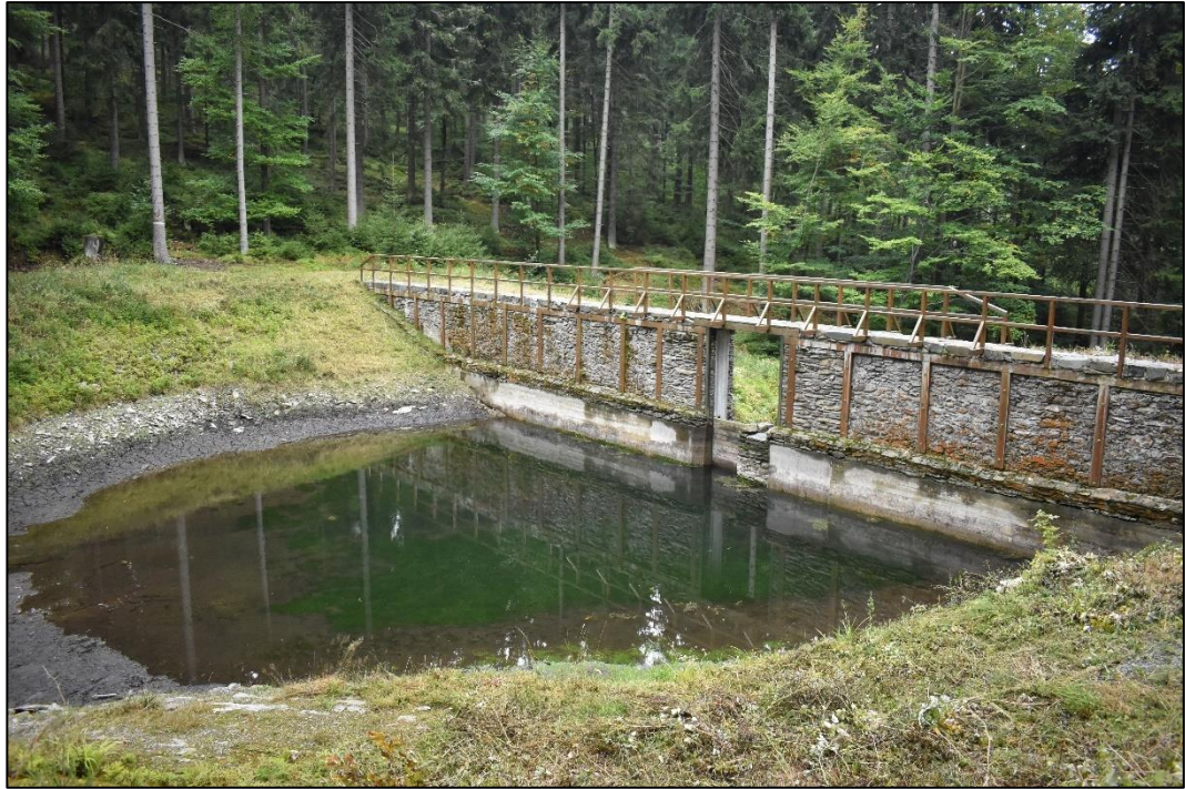
Obrázek 13. – Retenční nádrž pod Zvoničkou (zdroj: vlastní zpracování)
