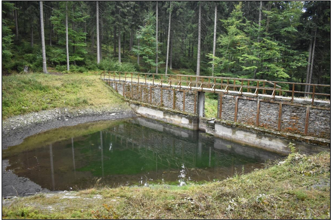
Obrázek 13. – Retenční nádrž pod Zvoničkou (zdroj: vlastní zpracování)
