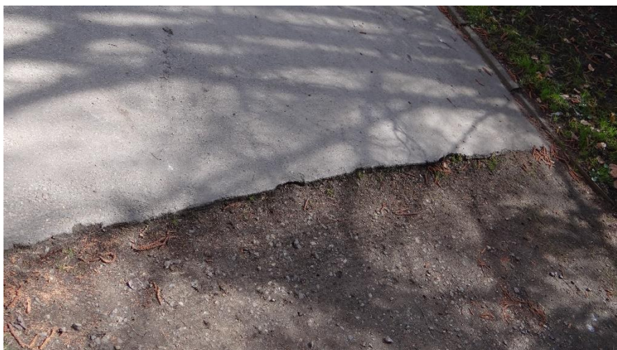
Obr. č. 32, Poničený nevzhledný povrch cesty (foto vlastní)
