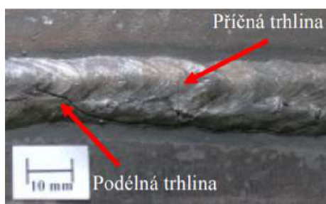
Obr. 4.0 Trhliny ve svaru [32]
