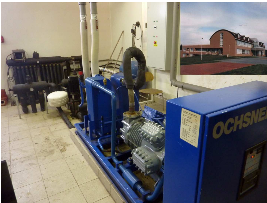
Obr. 22 Zařízení na geotermální ohřev vody pro vytápění školského areálu v Neveklově
