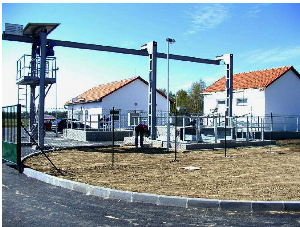
Obrázek 2.7 Čistírna odpadních vod Troubky [15]
