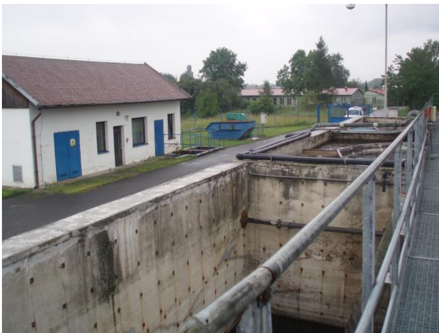
Příloha 1: ČOV Lom u Mostu - před intenzifikací (Telecká, 2016)
