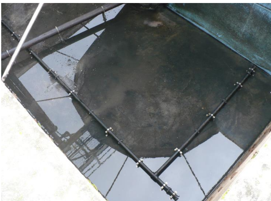
Příloha 11: Biologická část s rozvodem aerace (Telecká, 2020)
