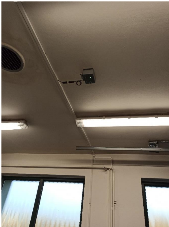
Obr. č. 25 Detektor na měření LPG (umístěn na stropu)
