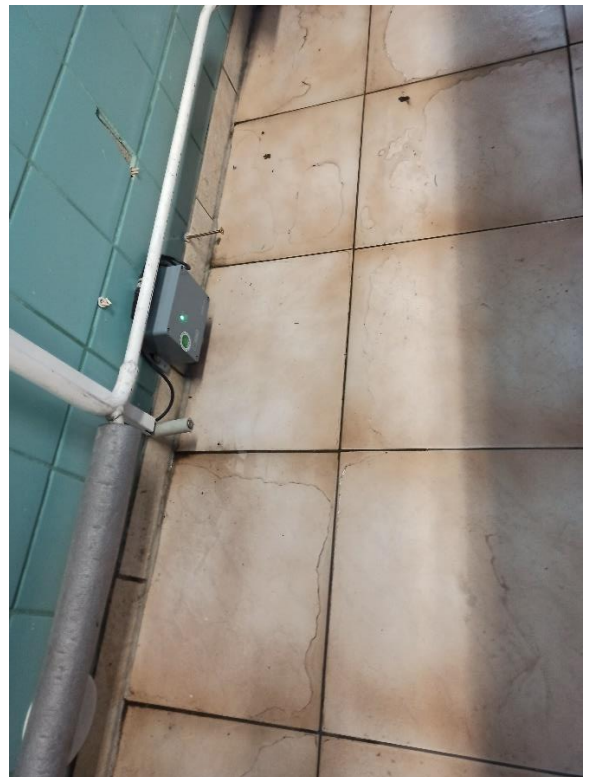
Obr. č. 26 Detektor CNG (umístěn u země)
