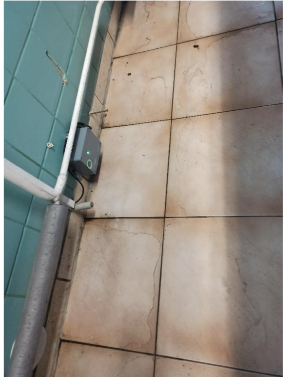
Obr. č. 26 Detektor CNG (umístěn u země)
