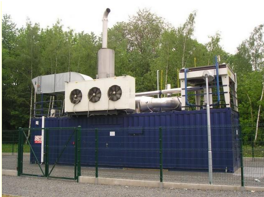
Obr. 3-2: Kogeneračná jednotka Quanto D770 KON, Orlová
