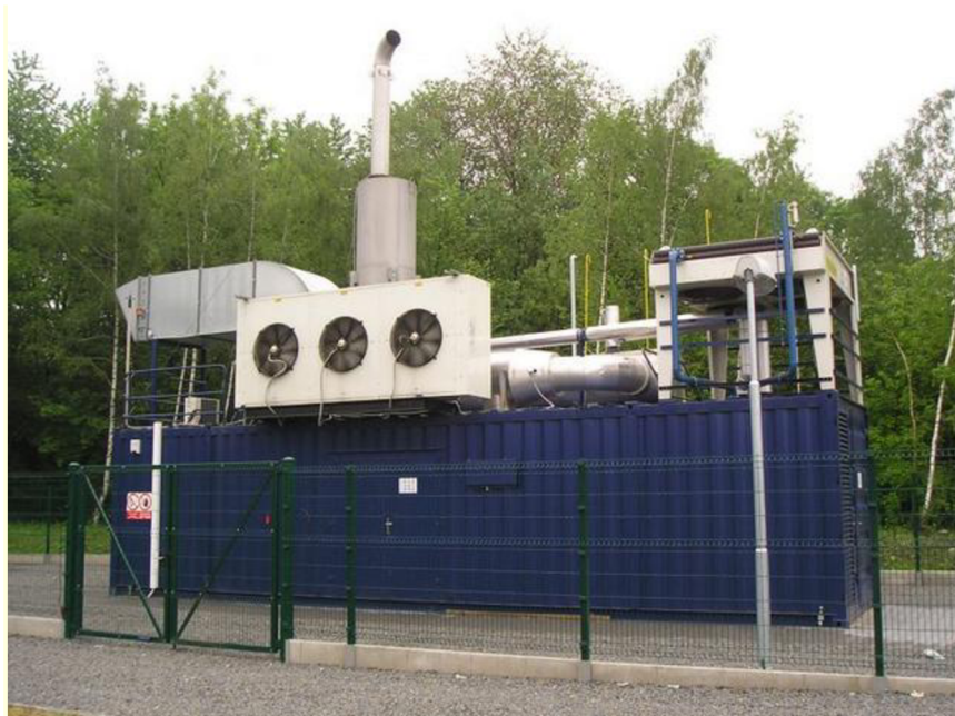
Obr. 3-2: Kogeneračná jednotka Quanto D770 KON, Orlová
