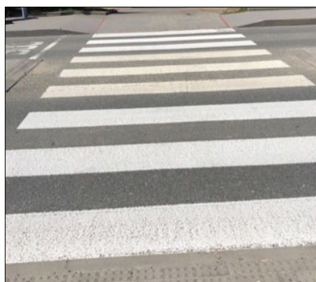
Obr. č. 80 Přechod po obnově barvou [vlastní]
