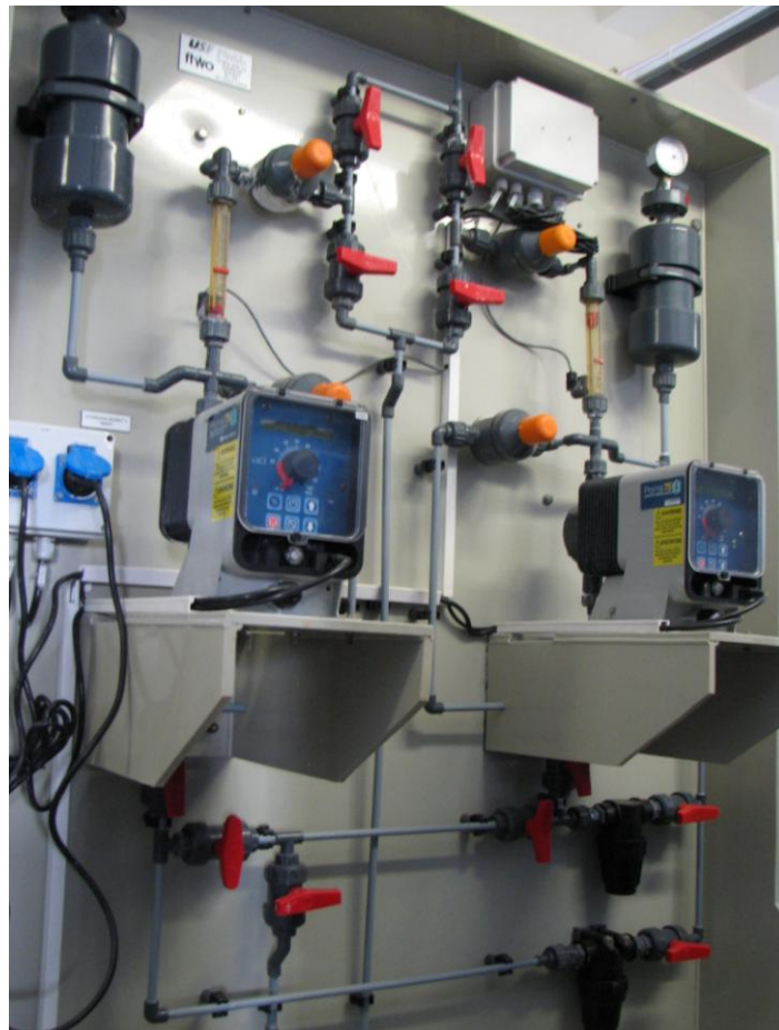
Obr. 17: Čerpadla pro dávkování hydroxidu sodného
