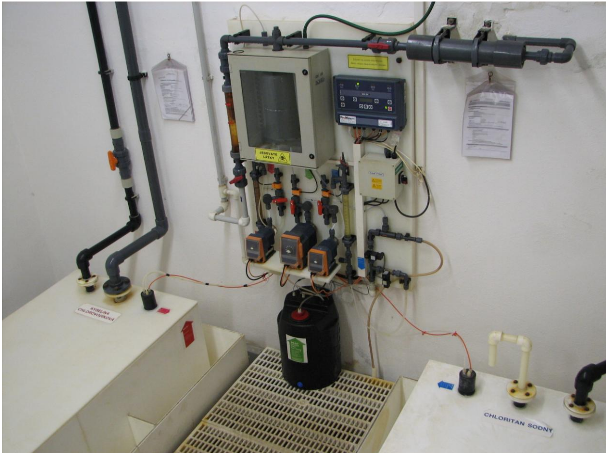
Obr. 18: Generátor chlordioxidu se zásobníky kyseliny chlorovodíkové a chloritanu sodného a s kanystrem na ředící vodu
