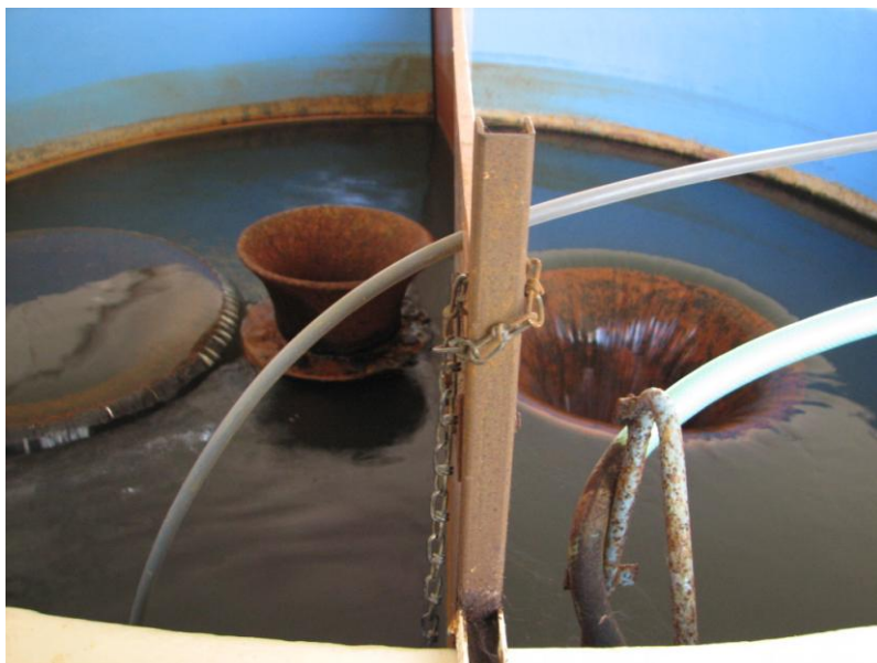
Obr. 13: Přítoková kašna se zavedeným dávkováním manganistanu draselného a koagulantu, uprostřed normá stěna
