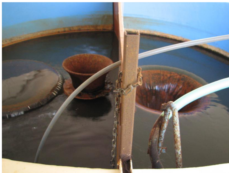
Obr. 13: Přítoková kašna se zavedeným dávkováním manganistanu draselného a koagulantu, uprostřed normá stěna
