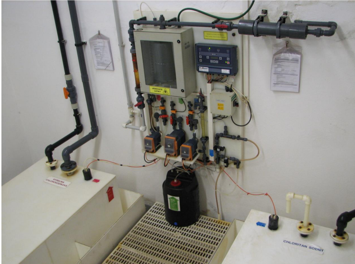
Obr. 18: Generátor chlordioxidu se zásobníky kyseliny chlorovodíkové a chloritanu sodného a s kanystrem na ředící vodu
