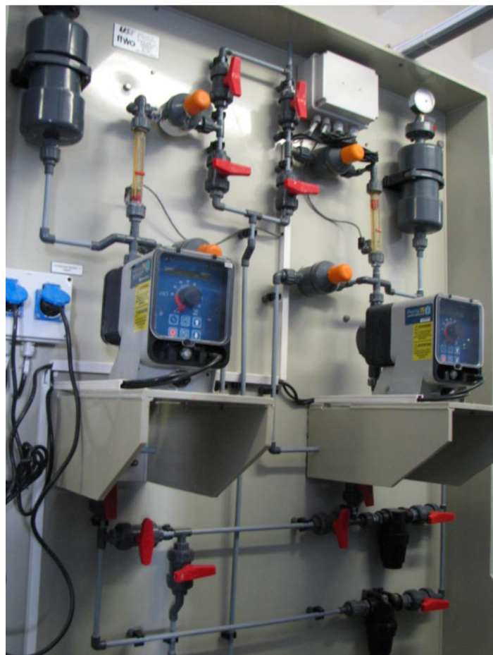
Obr. 17: Čerpadla pro dávkování hydroxidu sodného
