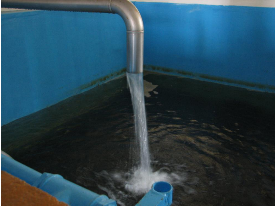
Obr. 10: Potrubí nuceného odtahu ze středové části čířiče ústí nad hladinu vody ve filtru, přívodní žlaby jsou zcela zatopené
