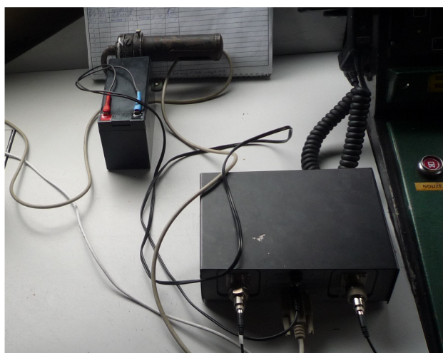
Obr. 4.4: Měřicí přístroj s baterií
