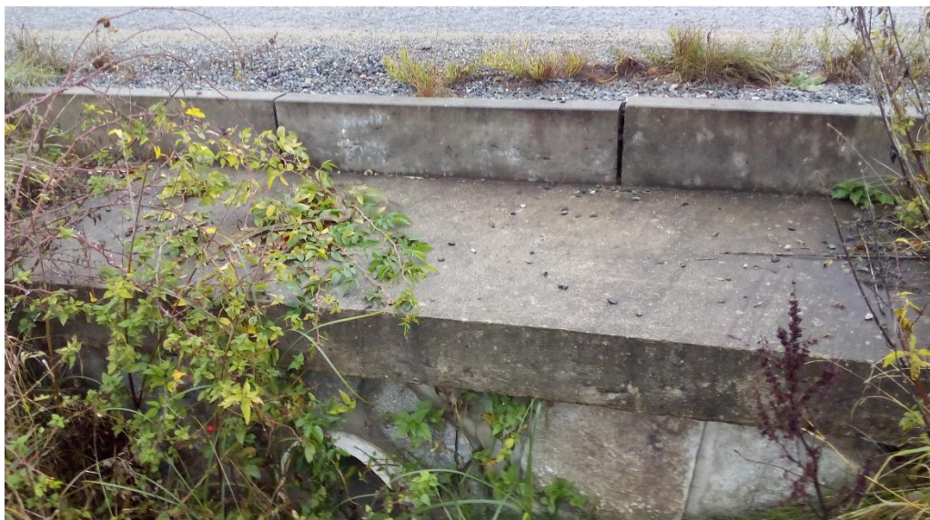
Obrázek č. 18: Zarostlý propustek
