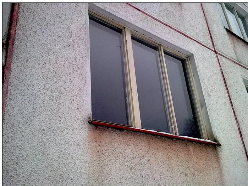
Obr. 34 Detail poškození oken před výměnou
