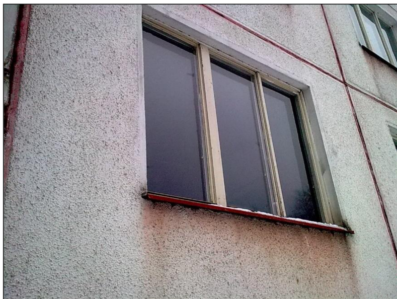
Obr. 34 Detail poškození oken před výměnou
