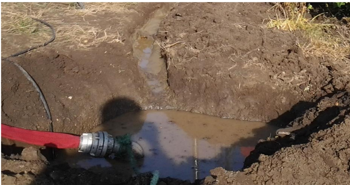
Obr.6-3. Použití elektrického kalového čerpadla Sigma 80-KDFU-150
