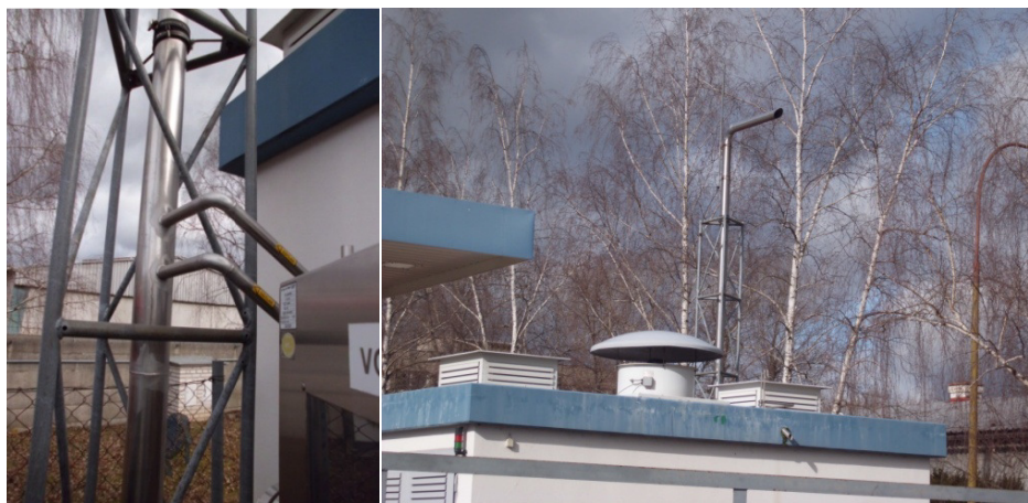
Obrázek 1: Svody do odvzdušňovacího komínu a odvzdušňovací komín neratovické plnicí stanice na vodík (autor)
