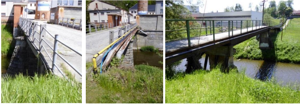
Obr. 3.68 - 3.70: Trubní lávky na silničním mostu (ř. km 34,74) a lávce pro pěší (ř. km 34,895)
