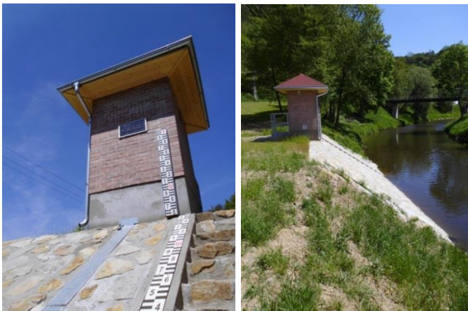
Obr. 2.13 a 2.14: Vodoměrná stanice – Náměšť nad Oslavou [38]
