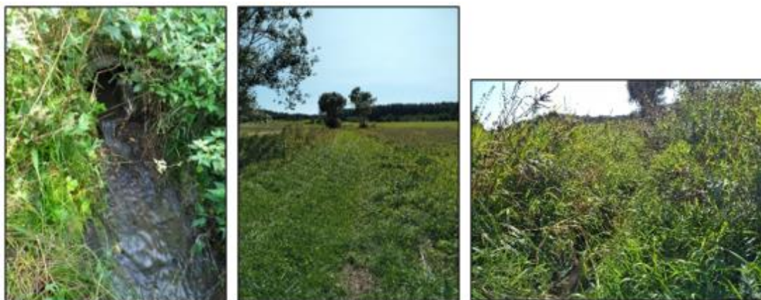
Obrázek 44: HMZ 10173811 - a) konec zatrubnění, b) pohled jižním směrem k mostku, c) pohled na zarostlé koryto
