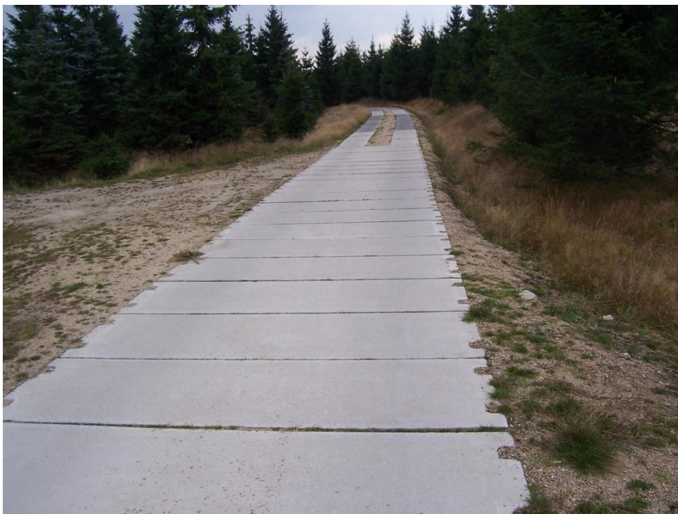
Obrázek č. 30: Panelový povrch - porušení II. třídy (příčné panely)
