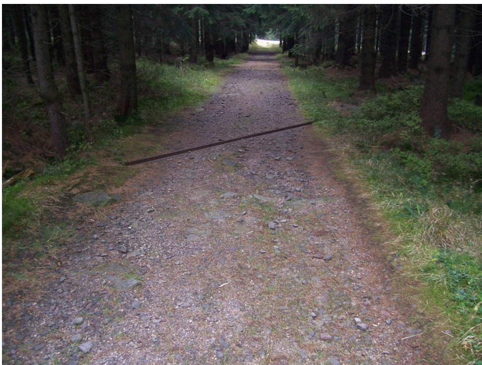
Obrázek č. 35: Štěrkový povrch - porušení III. třídy
