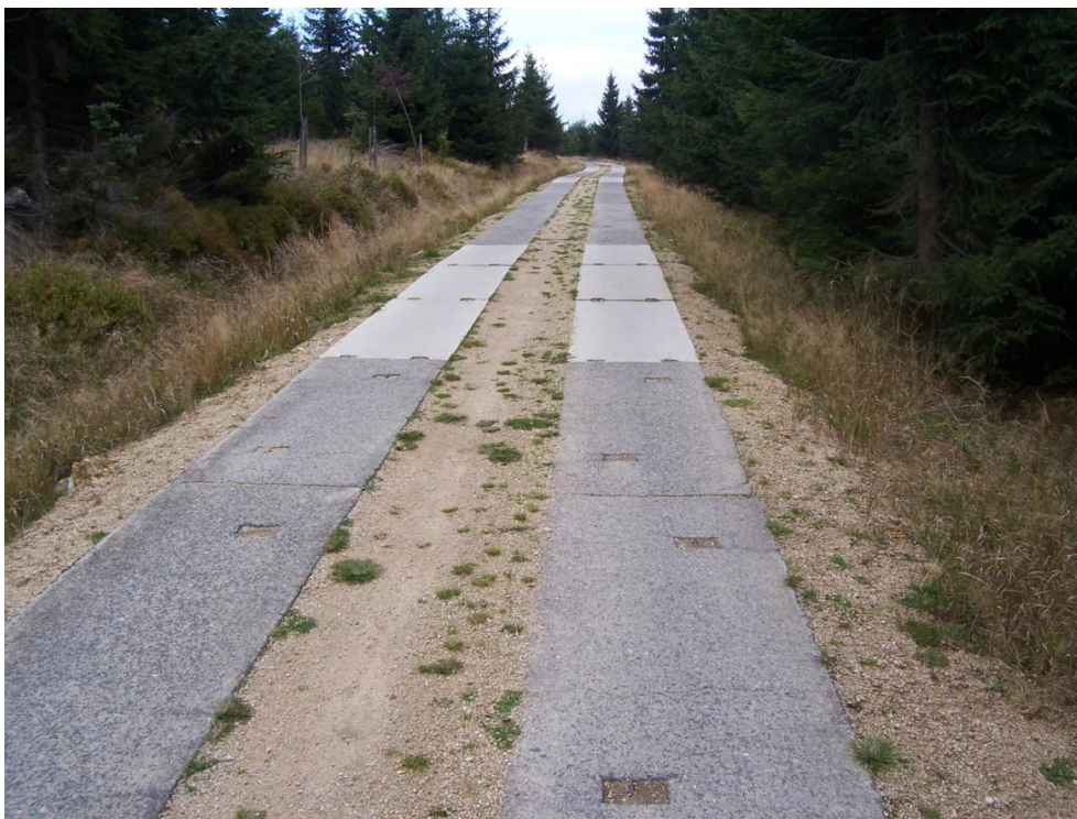
Obrázek č. 29: Panelový povrch - porušení II. třídy (kolejové panely)
