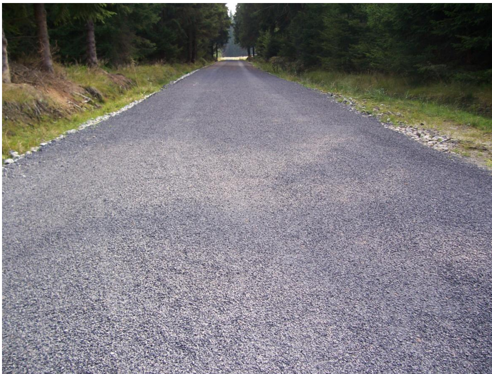
Obrázek č. 33: Štěrkový povrch - porušení I. třídy
