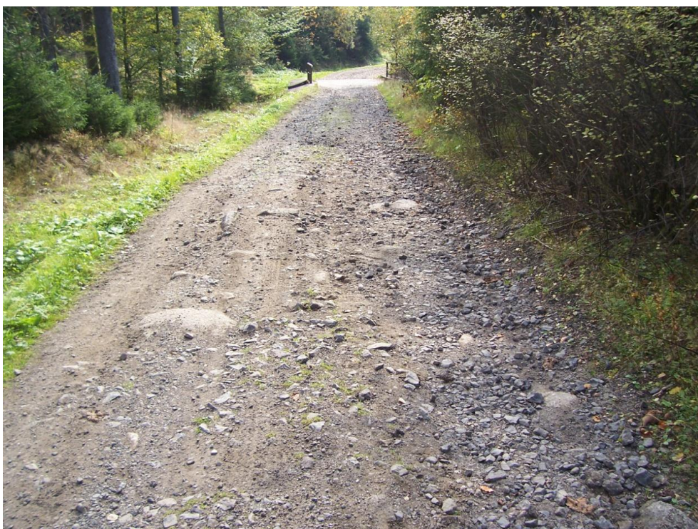
Obrázek č. 37: Štěrkový povrch - porušení V. třídy
