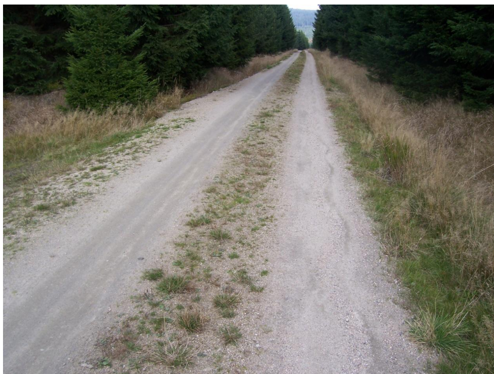
Obrázek č. 39: Zemní cesta - porušení II. třídy
