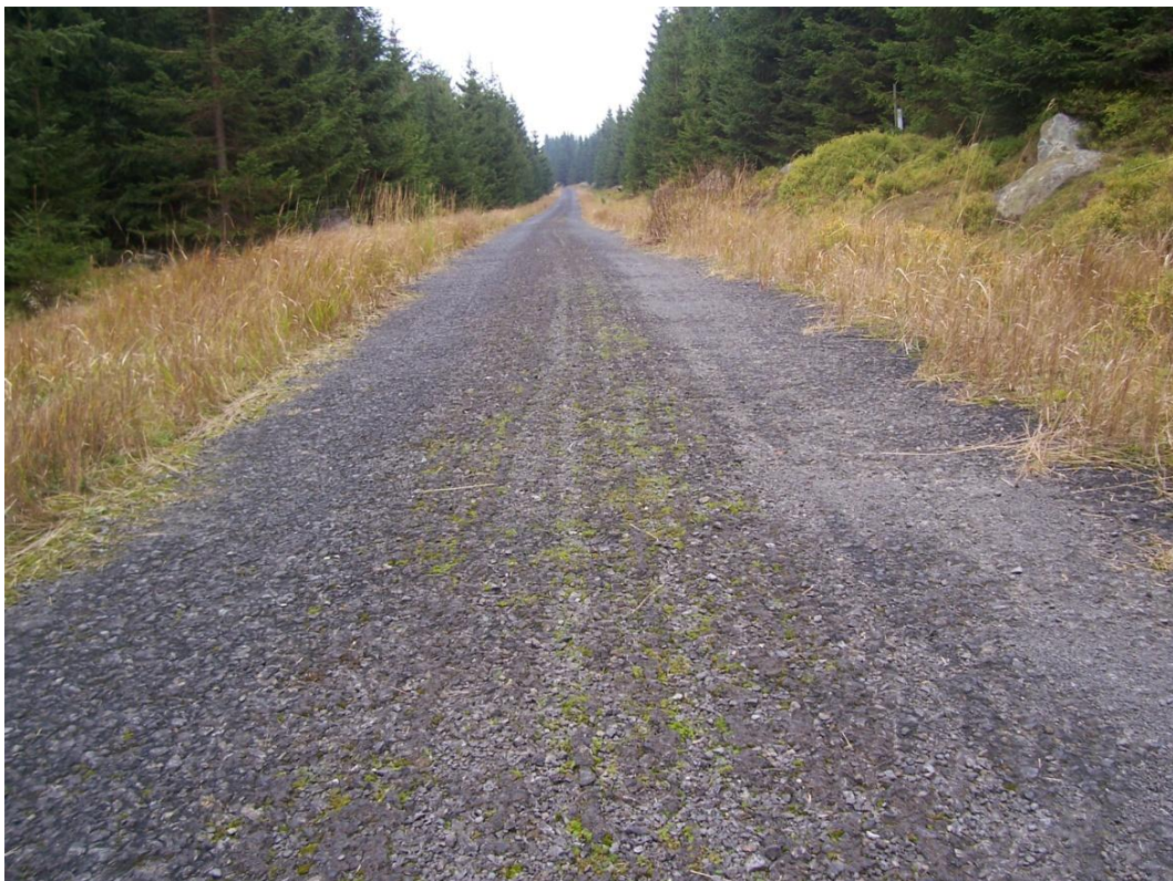
Obrázek č. 27: Bitumenový povrch - porušení III. třídy
