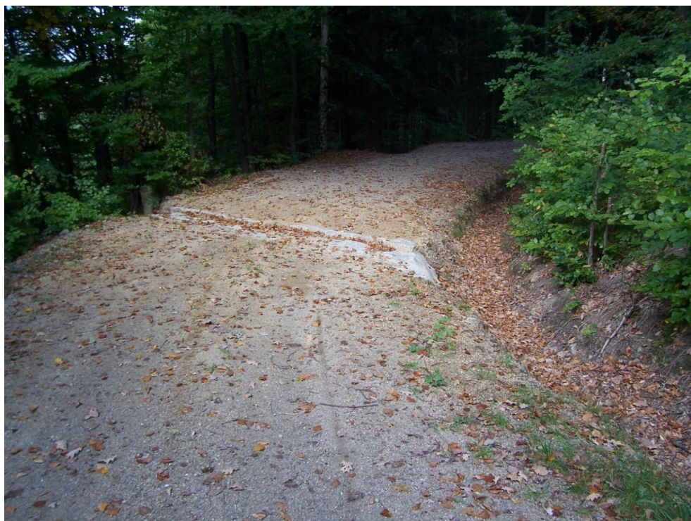
Obrázek č. 38: Zemní cesta - porušení I. třídy
