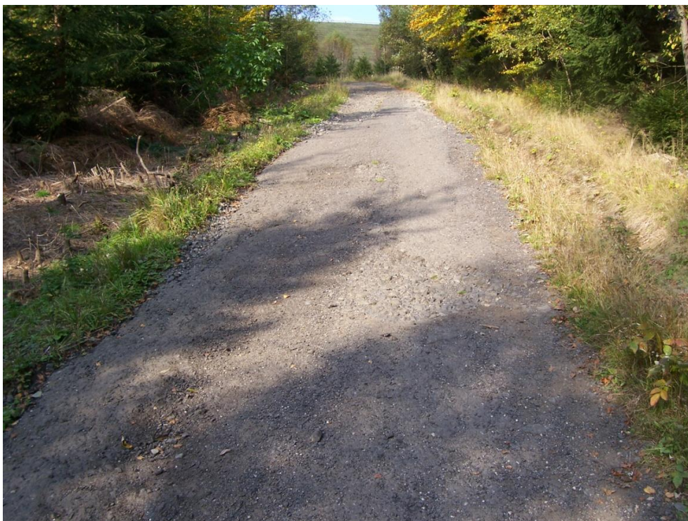
Obrázek č. 28: Bitumenový povrch - porušení IV. třídy
