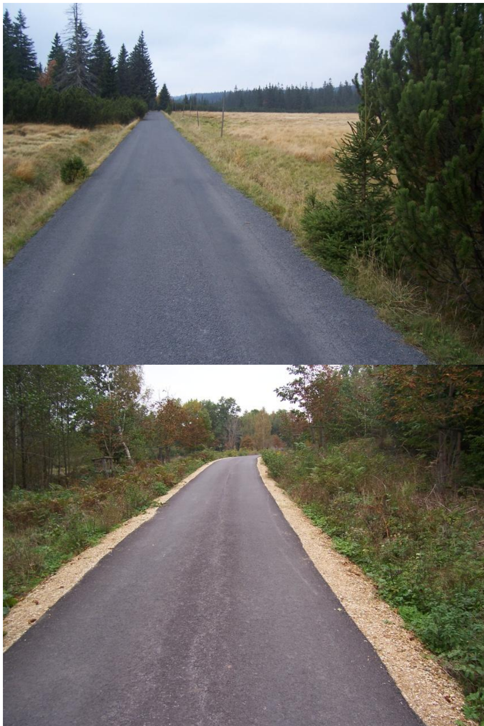
Obrázek č. 25: Bitumenový povrch - porušení I. třídy
