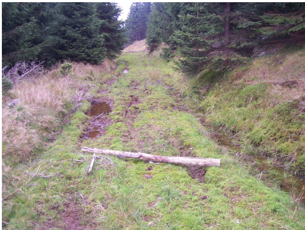
Obrázek č. 42: Zemní cesta - porušení V. třídy
