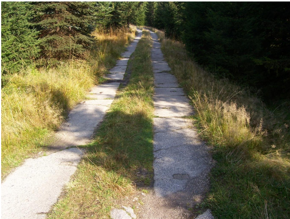
Obrázek č. 32: Panelový povrch - porušení IV. třídy
