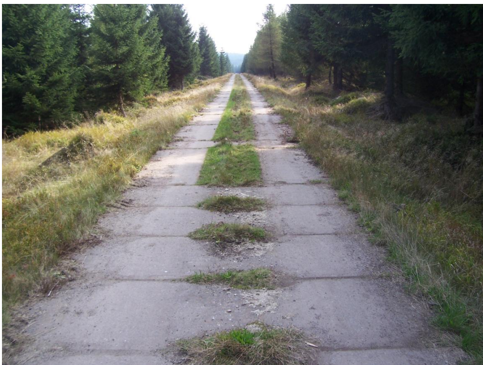
Obrázek č. 31: Panelový povrch - porušení III. třídy
