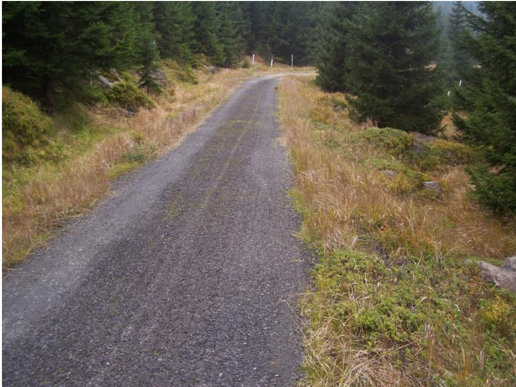
Obrázek č. 26: Bitumenový povrch - porušení II. třídy
