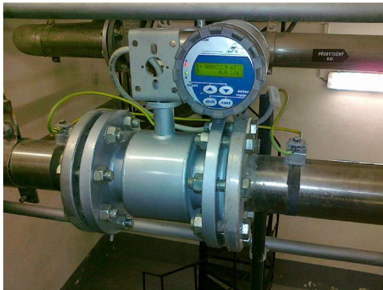
Obr. 7.2 Magneticko - indukční průtokoměr ELA Brno DN 80 [8]
