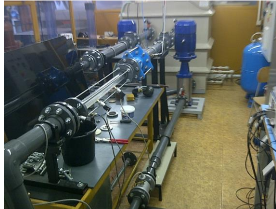
Obr. 5.2. Hydraulická měřicí trať [11]
