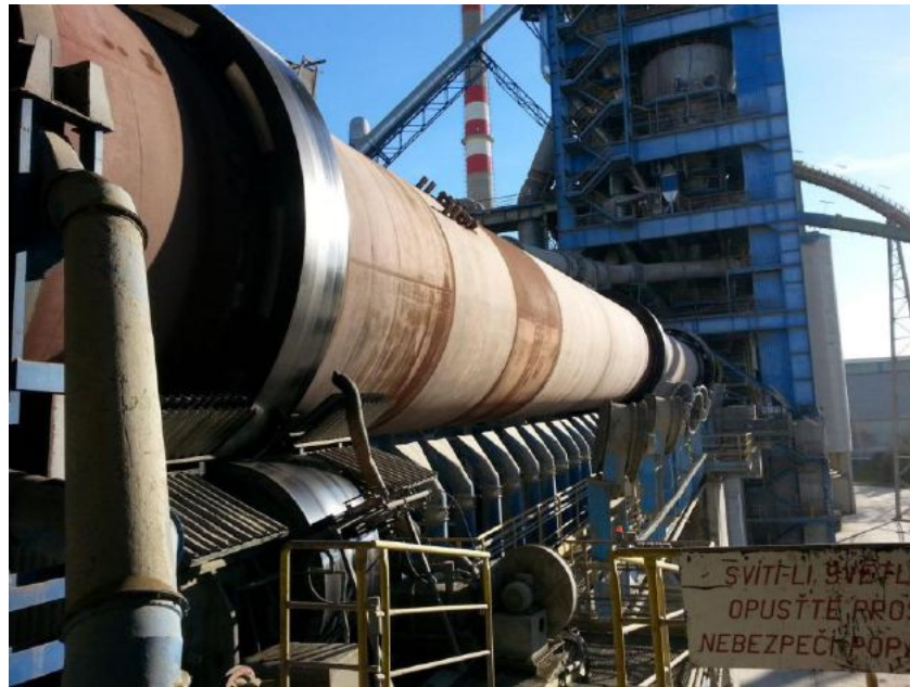
Foto č. 2: Pohled na rotační pec s výměníkem
