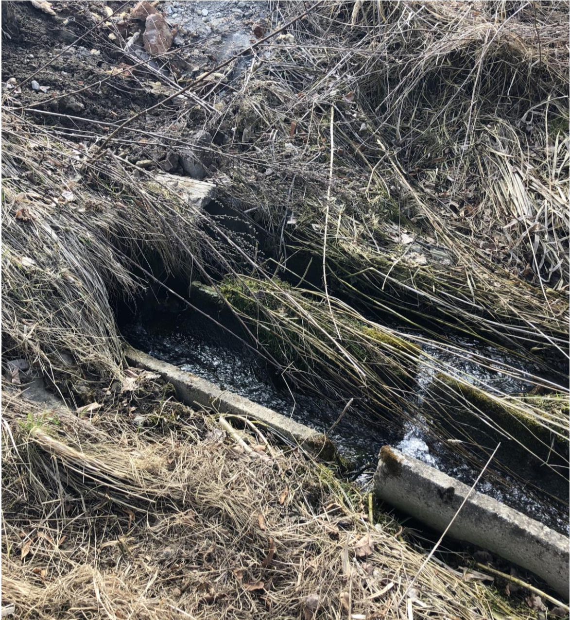
Obr. 12) Odtokové potrubí [autor]
