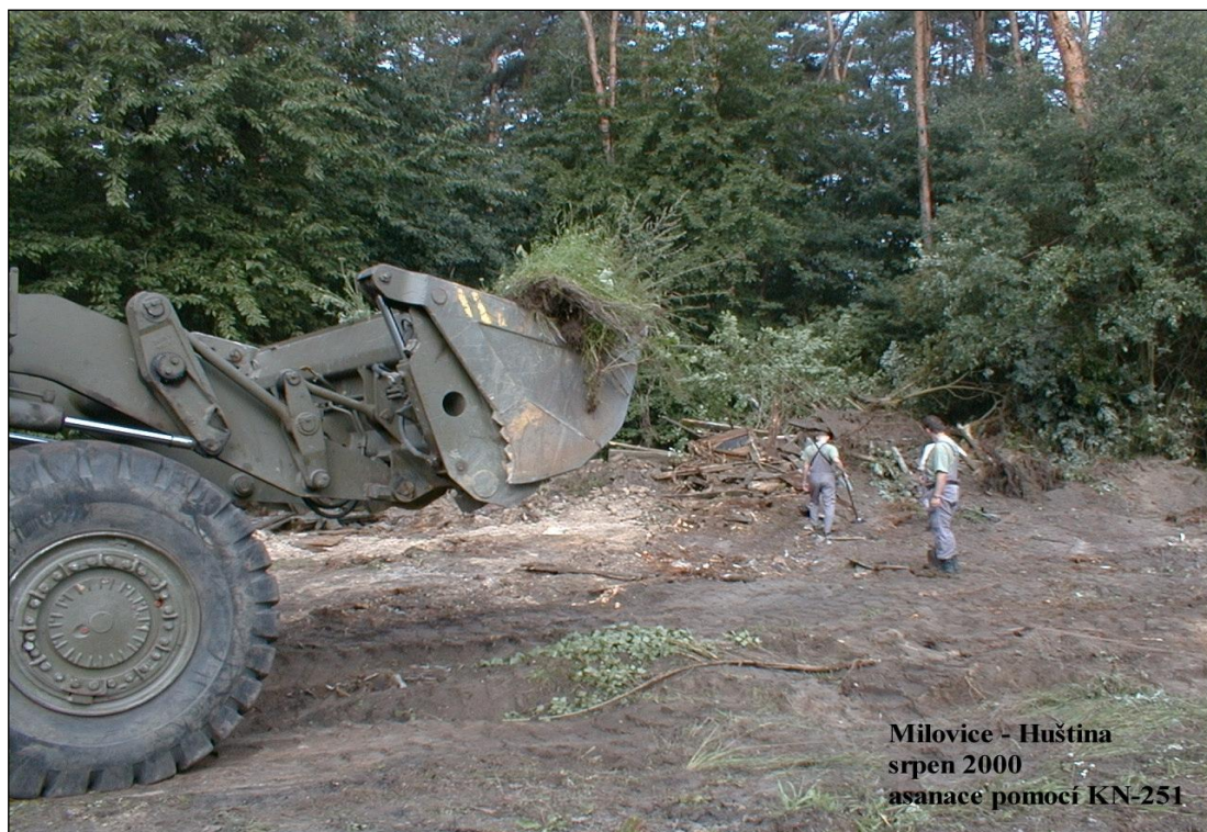
Obrázek 2 Poškození půdního pokryvu těžkou technikou Zdroj: archiv M. Pištěka
