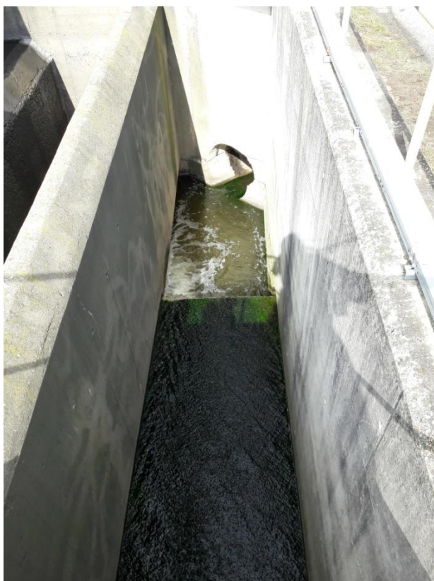
Odtok vyčištěných vod z ČKV+ČOV Sever
