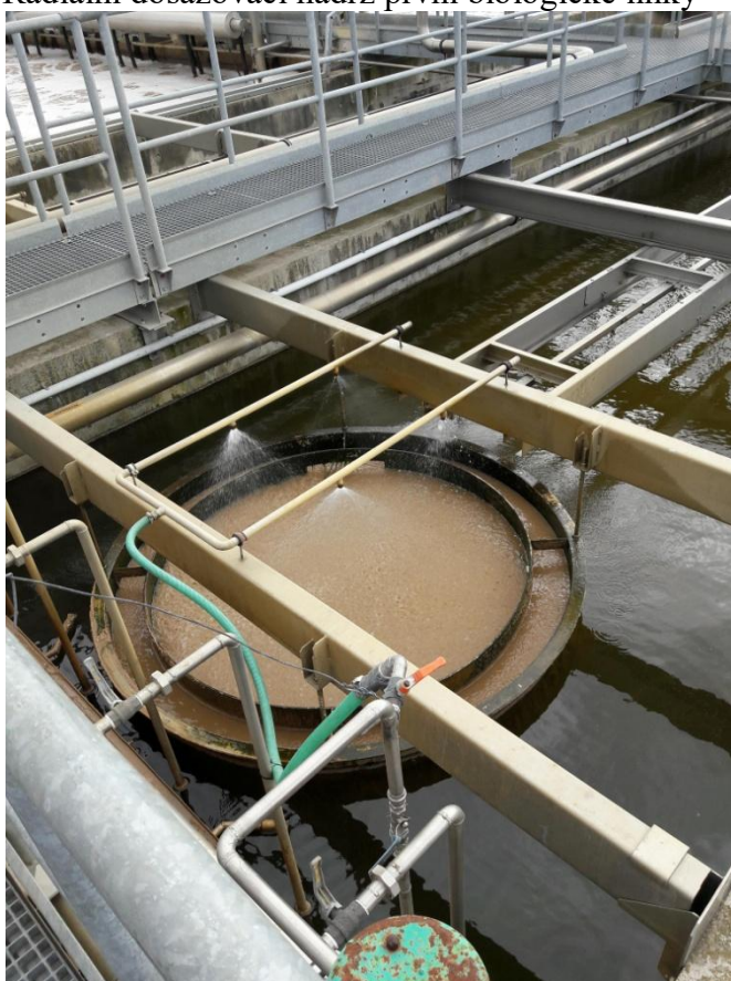
Dosazovací nádrž druhé biologické linky
