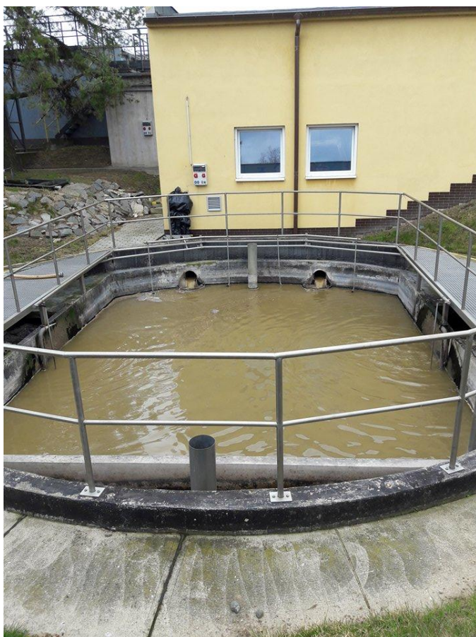
Štěrbínová nádrž na přítoku splaškových vod
