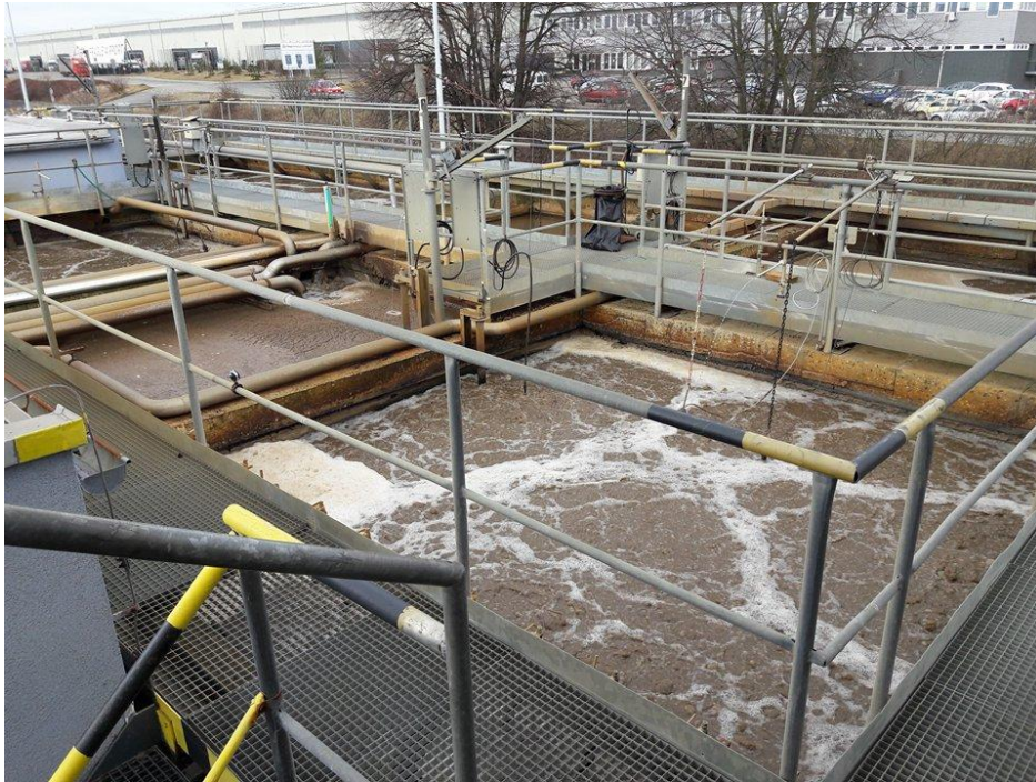
První biologická linka pro čištění odpadních vod
