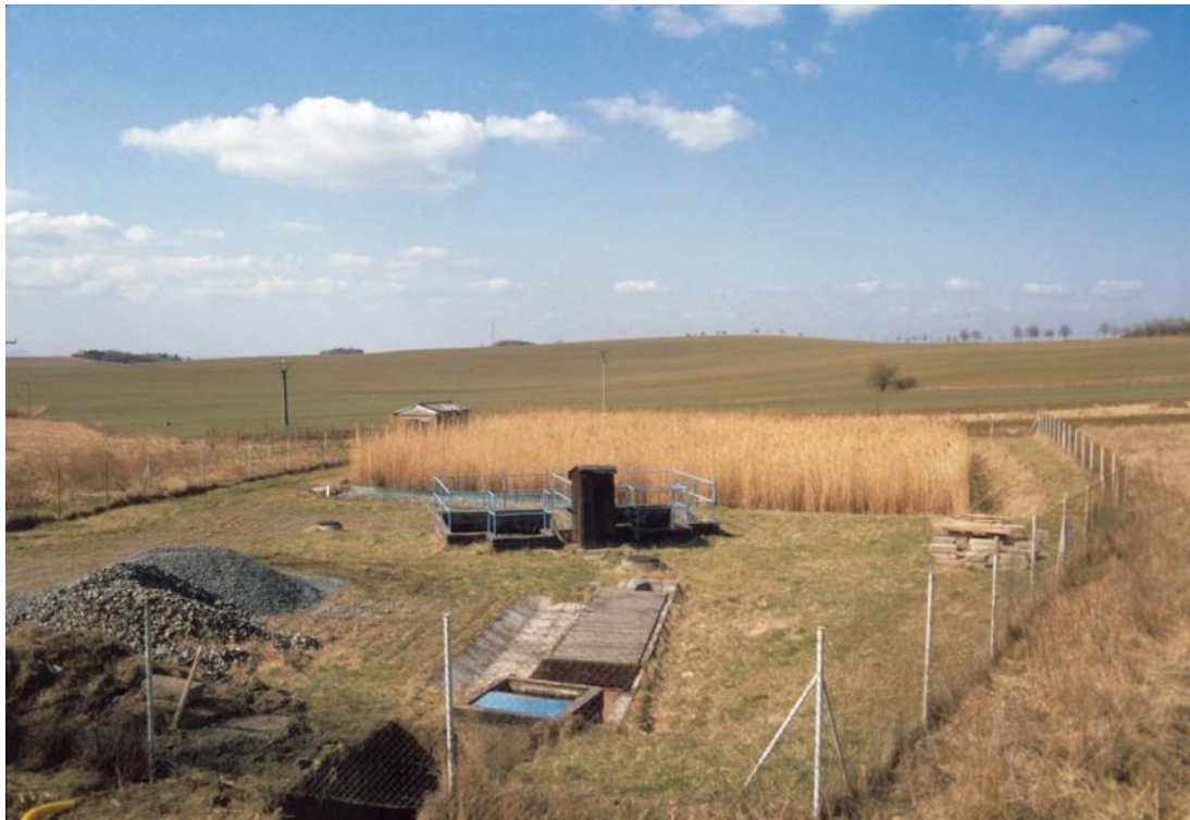
Obrázek 4 , kořenová čistírna v obci Ondřejov ( www.ceskaenergetika.cz ).
