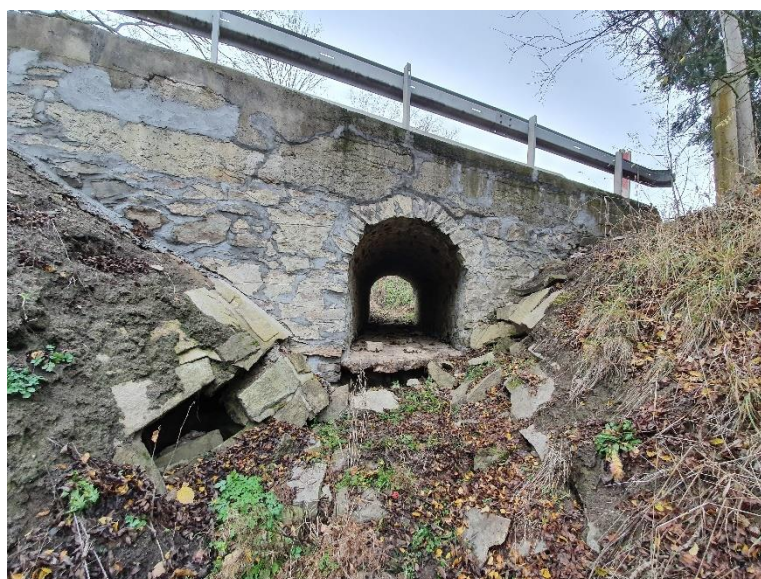
Obrázek 15: Podemletá část mostu přes silnici III. třídy
