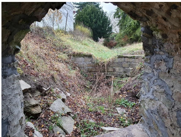
Obrázek 14: Zaústění příkopu do dešťové stoky VT2
