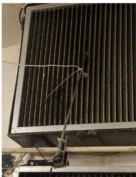
Obrázek 3.3: Ventilace a upevnění sondy Testo 435
