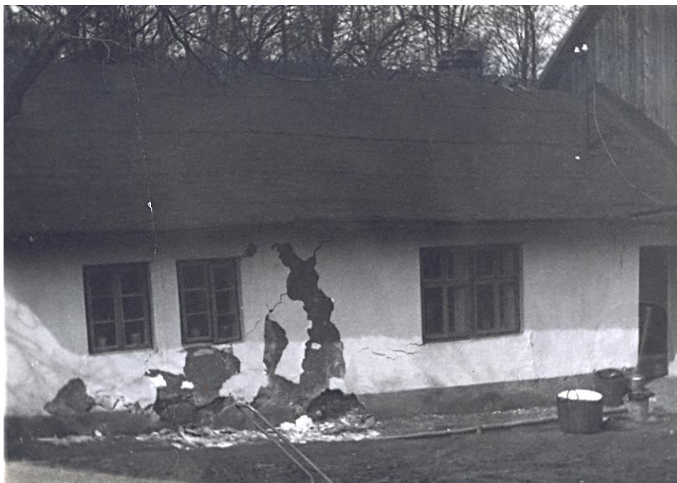
Obr. 2 Poškozený dům pod svahem, č.p. 199 (zdroj: obecní úřad Halenkovice)
