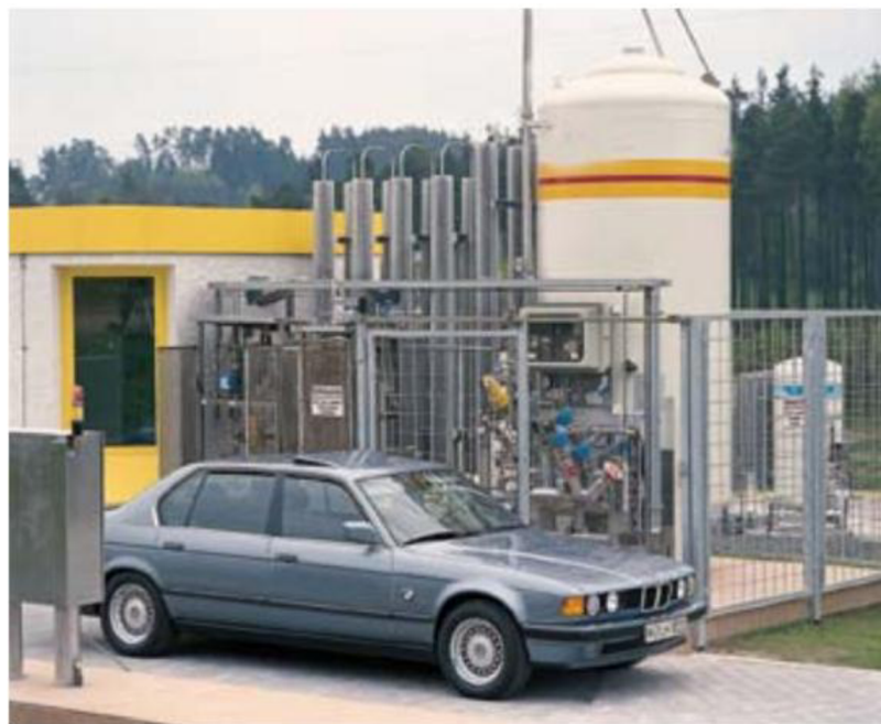
Obr. 27 Čerpací stanice vodíku pro pohon vozidel [9]
