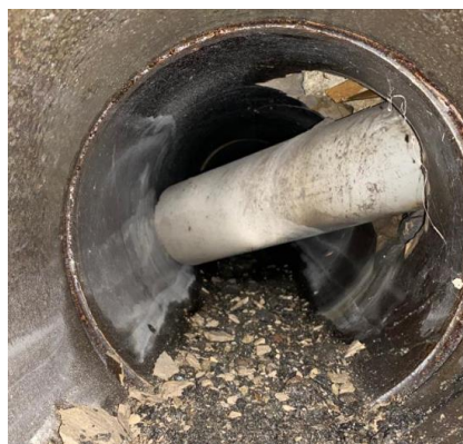
Obrázek 21 - Cizí předmět v potrubí (Vlastní)
