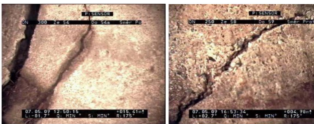
Obrázek 4: Příčná a podélná prasklina (dostupné z http://www.hercikakriz.cz/poradna/clanky/nejcastejsi-zavady-na-kanalizaci-a-mozne-zpusoby-opravy )
