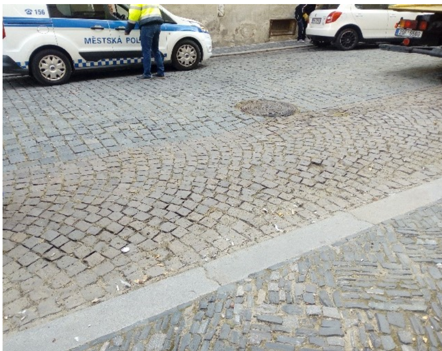
Příloha 2 – U poklopu kanalizace je zřetelný pokles komunikace. (vlastní tvorba)
