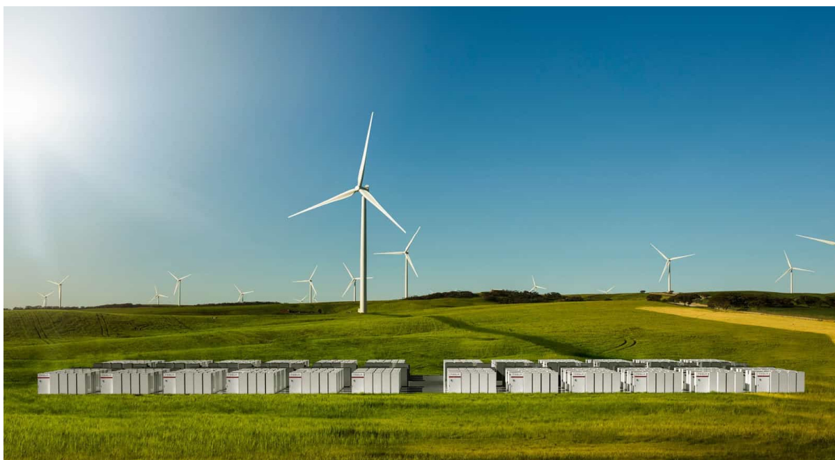
Obr. 18 Tesla Powerpack akumulující elektrickou energii z větrných elektráren [89]
