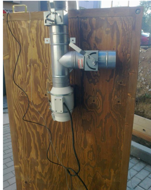
Obr. 10: zadní strana kolektoru s ventilátorem a regulačními klapkami
