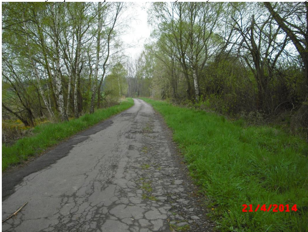
Příloha č. 6 - foto poškození povrchu značené cyklotrasy č.0070 Karhule – Lesáky
