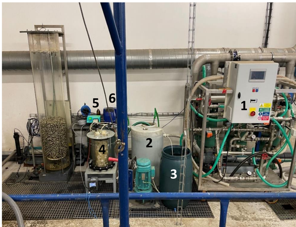
Obr. 6 Poloprovozní systém post-nitrifikace s kolonou (na ČOV Amazon) pro testování vyvinutých nosičů S: 1. filtrační jednotka s keramickým membránovým modulem; 2. barel s kalem z nitrifikační nádrže; 3. barel na jímání permeátu z filtrační jednotky; 4. kolona s nosiči; 5. peristaltické čerpadlo; 6. vzduchové dmychadlo
