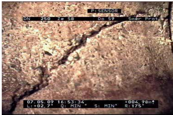
Obr. 5.6 Trhlina na potrubí [27]
