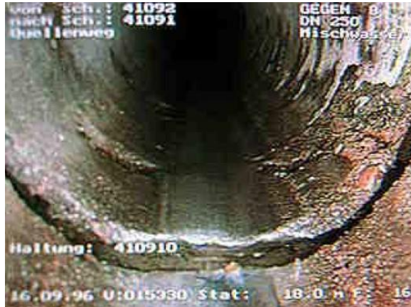
Obr. 5.1 Netěsný spoj kanalizačního potrubí [22]
