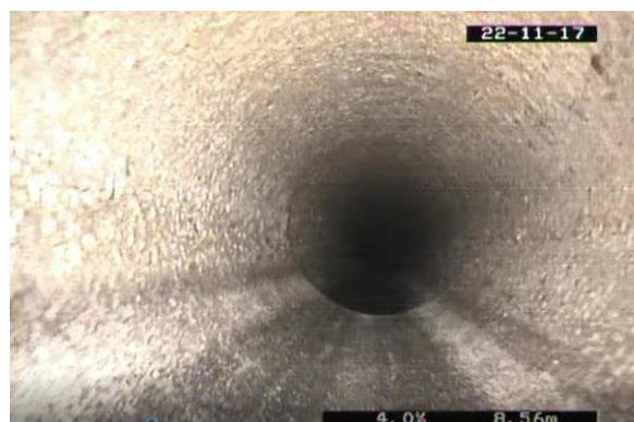
Obr. 12.4 Koroze biogenní kyselinou sírovou – bílý povlak na stěnách potrubí
