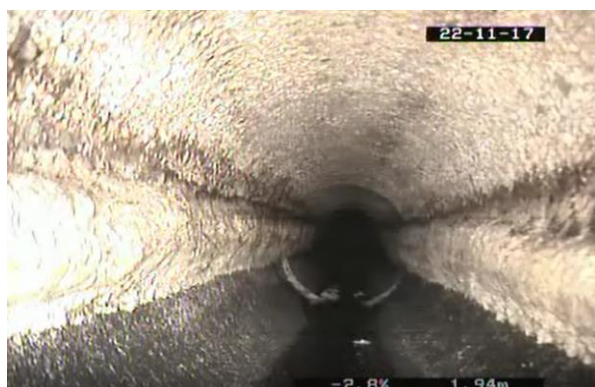
Obr. 12.3 Usazený tuk na stěnách
