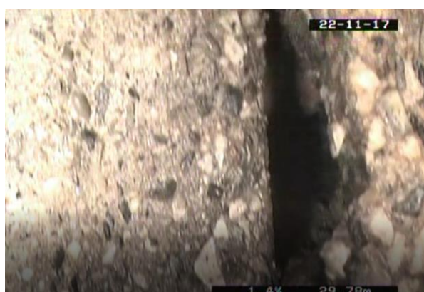
Obr. 12.5 Díra – viditelná zemina
