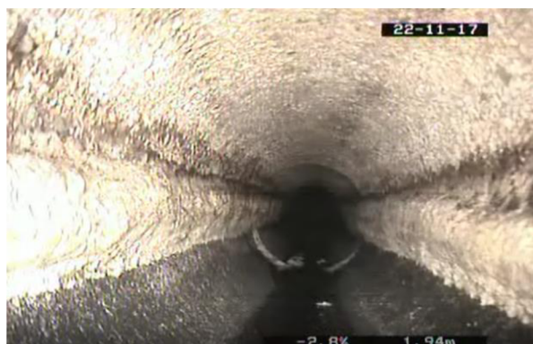
Obr. 12.3 Usazený tuk na stěnách
