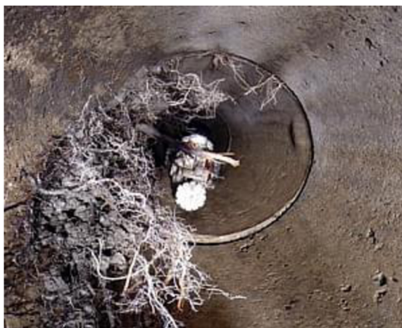
Obr. 5.2 Prorostlé kořeny do kanalizace [27]
