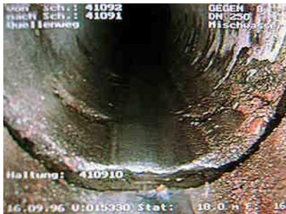
Obr. 5.1 Netěsný spoj kanalizačního potrubí [22]
