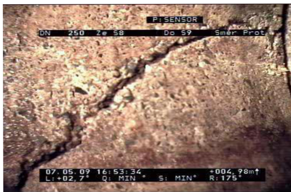
Obr. 5.6 Trhlina na potrubí [27]
