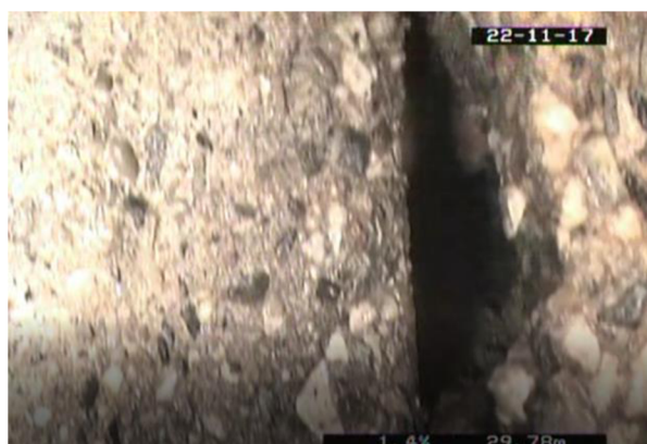
Obr. 12.5 Díra – viditelná zemina
