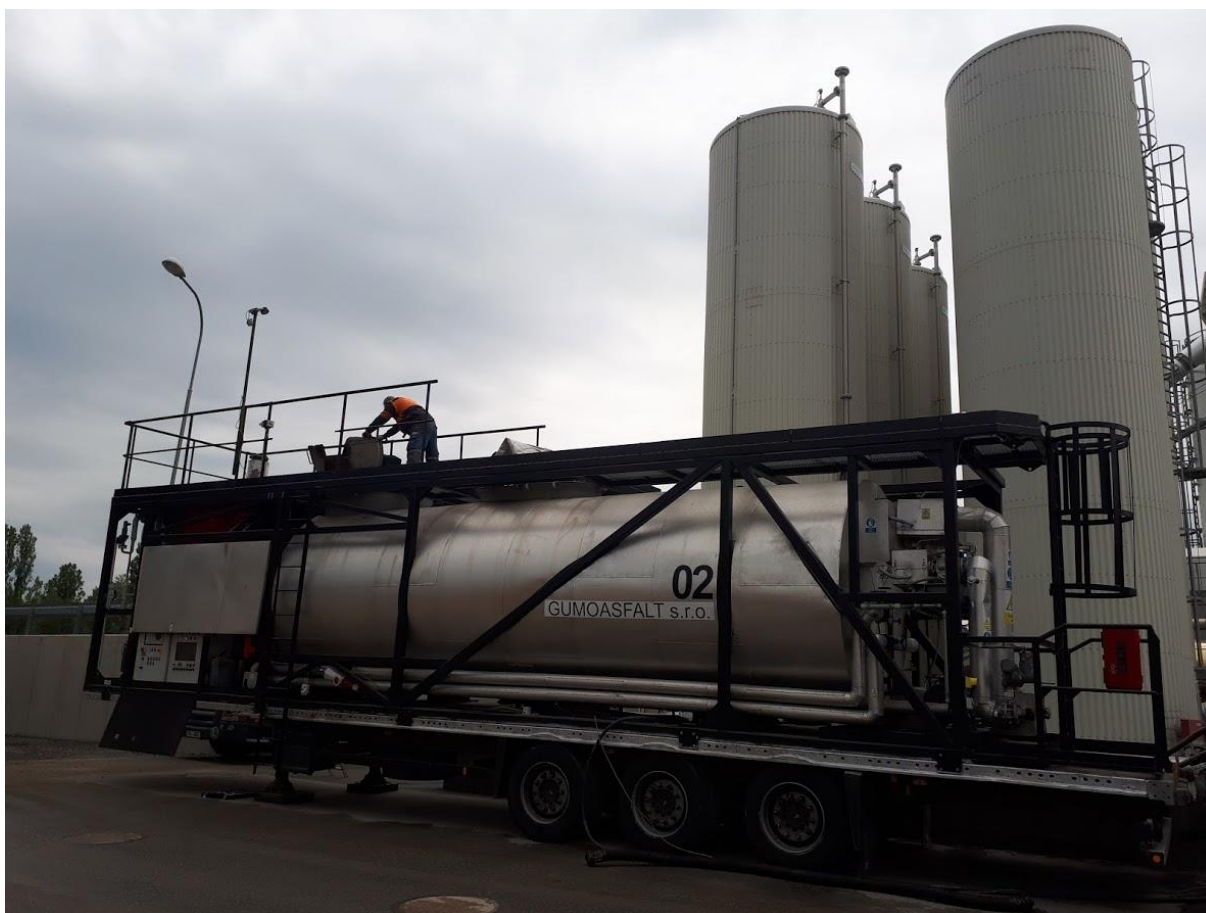
Obrázek 12: Mísicí zařízení pro výrobu asfaltového pojiva modifikovaného pryžovým granulátem
