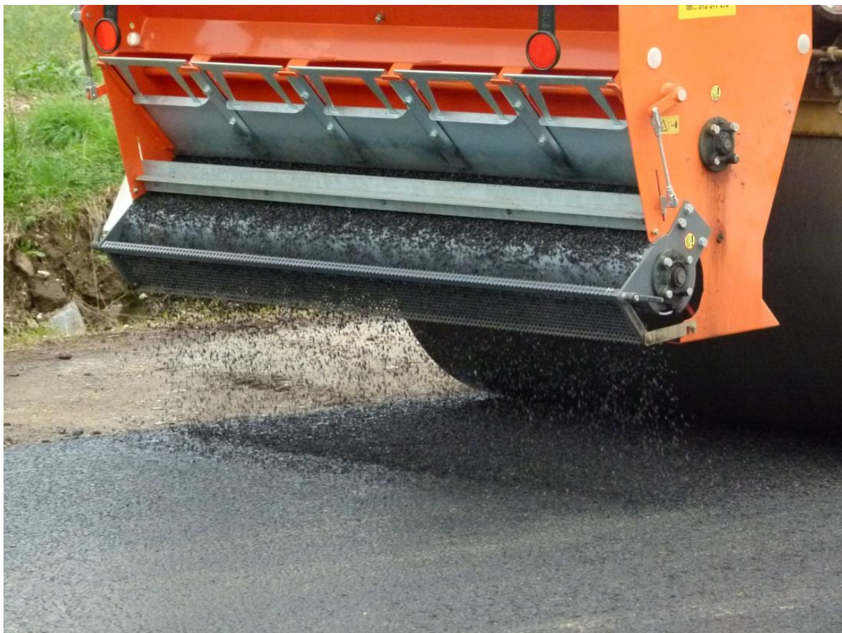
Obrázek 48: Podrcení povrchu směsi typu SMA 11S frakcí kameniva 0/4 pro zlepšení protismykových vlastností
