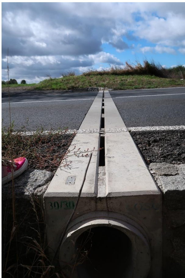
Obrázek 54: Stav detailu napojení štěrbinového žlabu poblíž železničního přejezdu v září 2018
