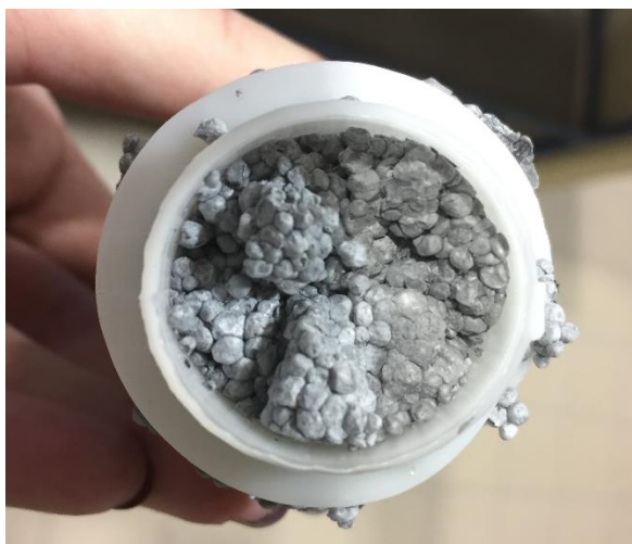
Obrázek 59: Plastová hmoždina po vytrhnutí z tepelného izolantu
